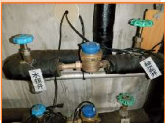
給水弁と水抜弁
